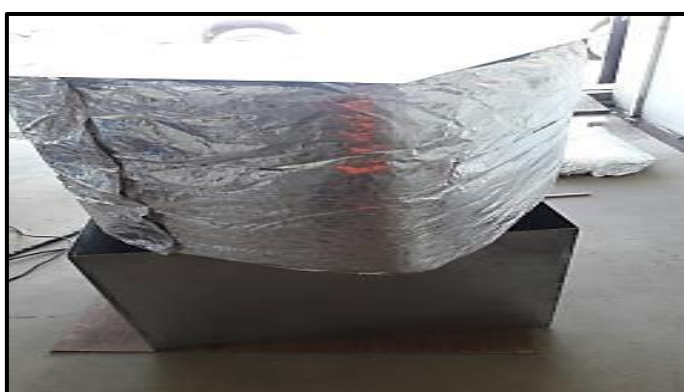
ภาพที่ 3-16 แสดงการติดตั้งฉนวนกันความร้อนรอบหม้อย้อมสี (ที่มา : วัทัญญ บุตรศรี, 2560)
