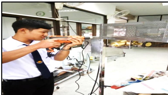
ภาพที่ 3-56 แสดงการติดตั้งตู้ควบคุมระบบไฟฟ้าเข้ากับโครงสร้างของเครื่อง (ที่มา : วทีญญ บุตรศรี, 2561)
