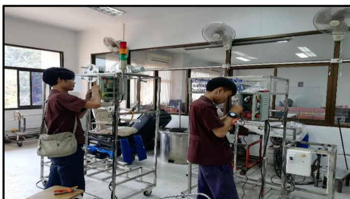
ภาพที่ 3-135 แสดงการประกอบตู้ควบคุมระบบไฟฟ้า (ที่มา : วทัญญู บุตรศรี, 2562)
