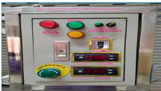
ภาพที่ 3-149 แสดงด้านหน้าของตู้ควบคุมระบบไฟฟ้า (ที่มา : วทัญญู บุตรศรี, 2562)
